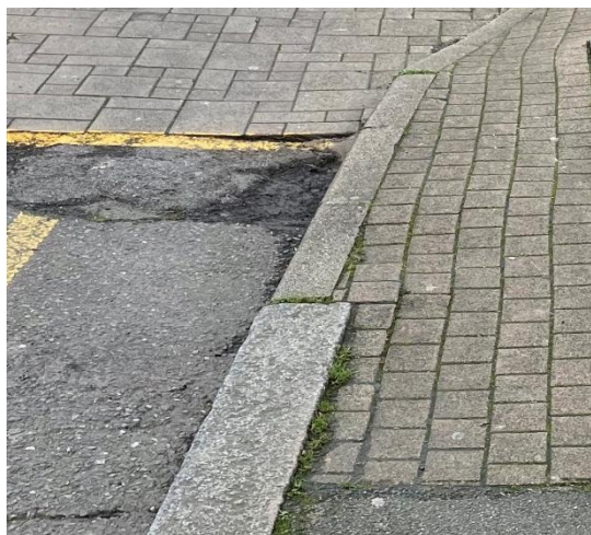
Bordures granit de récupération
